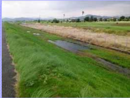
■排水不良・墳砂・漏水
