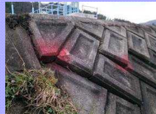
■その他（護岸の段差）
