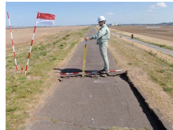
地震時の天端クラック事例(利根川)
