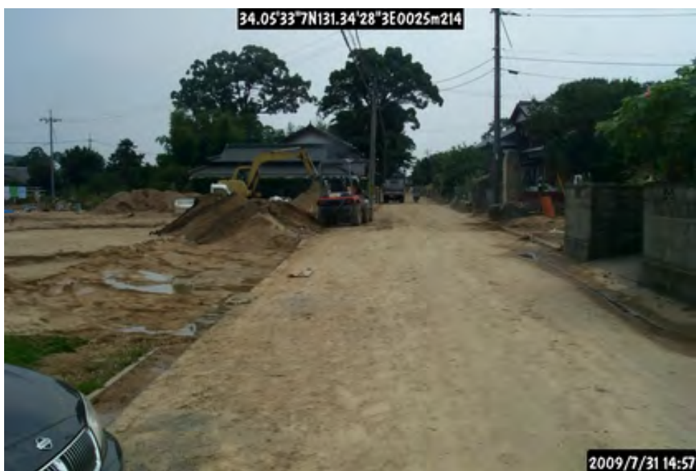
図 1-45 防府市上右田の現地観測写真（2009 年 7 月 31 日撮影）
