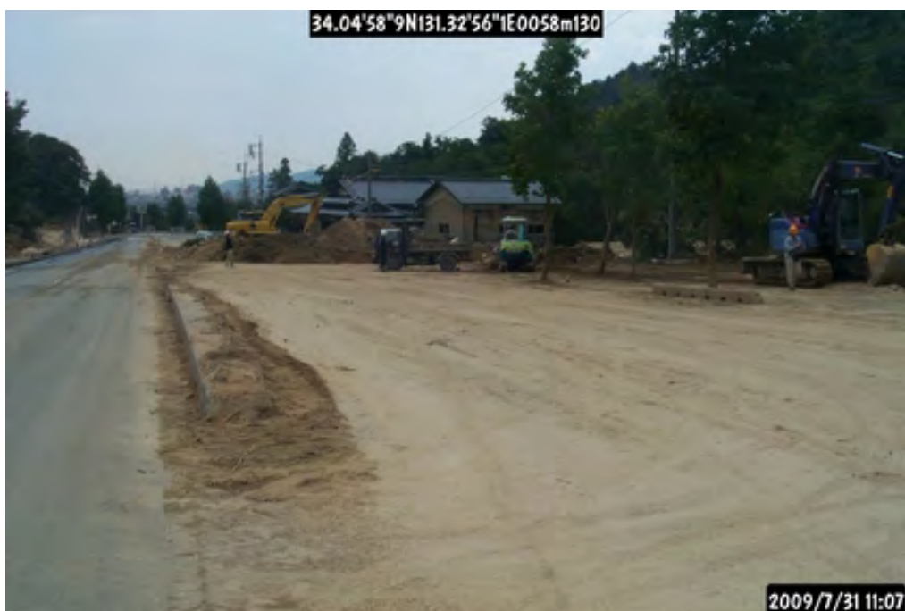
図 1-46 防府市下右田の現地観測写真（2009 年 7 月 31 日撮影）
