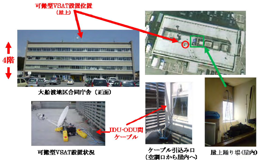
図 2.2-8 大船渡沿岸広域振興局への屋外装置（ODU）設置状況
