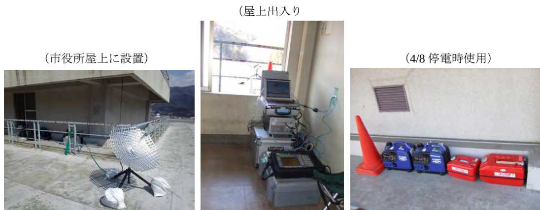
図 2.2-18 通信機器等の設置状況（左：90cmφ可搬型アンテナ、中央：可搬型通信端末、右：ポータブル発電機）
