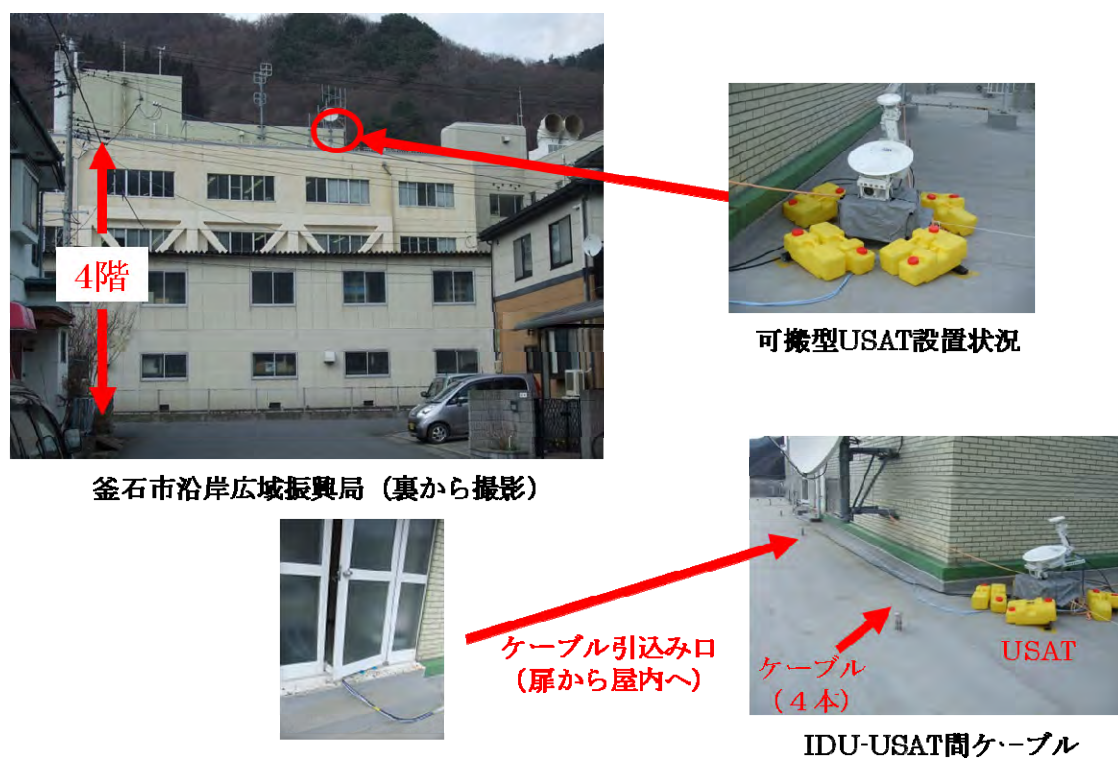
図 2.2-6 釜石市沿岸広域振興局への屋外装置（ODU）設置状況
