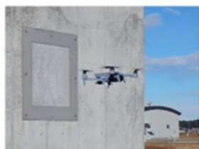
ドローンによる損傷把握
